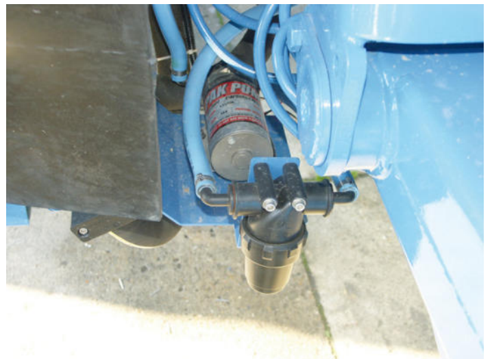
Pompe de fond de cuve
